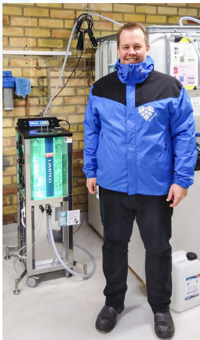
Thomas Johansson vid den nya Z-Water Generator Plus som är själva hjärtat i anläggningen som ska tillverka kommunens behov Z-Water.
